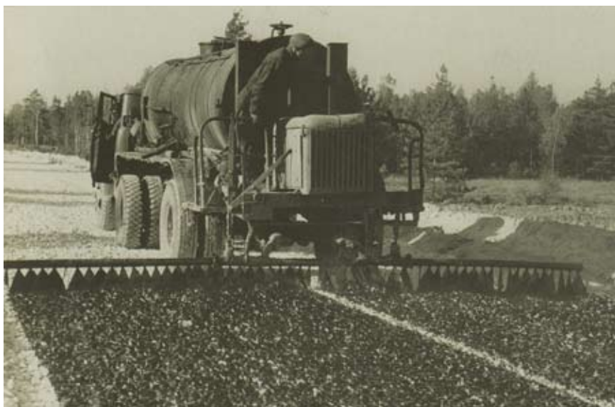
На строительстве дороги II технической категории «Обход г. Егорьевска» (участок «Егорьевск – Коломна – Кашира – Ненашево»). Идет подготовка щебеночного основания — розлив битума из гудронатора под укладку нижнего слоя асфальтобетонного покрытия. Работы ведет Егорьевское ДСУ №2. 1982 г.
